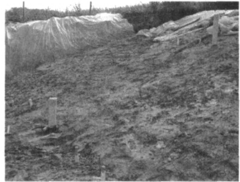
图 16 坡 II 第一次滑坡破坏现象
