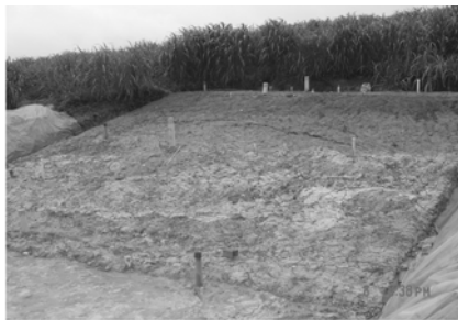
图 24 坡 II 第二次滑坡破坏现象
