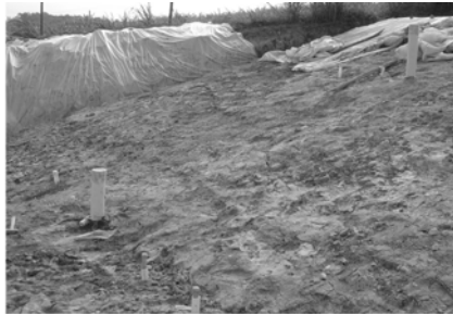
图 23 坡 II 第一次滑坡破坏现象
