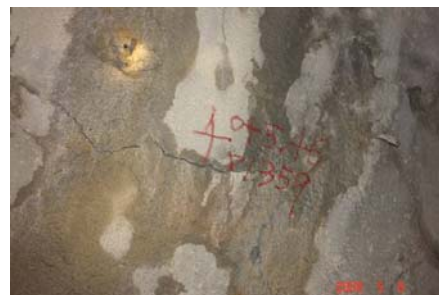
(b) 喷混凝土开裂现象
