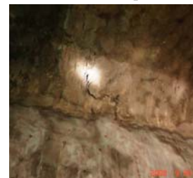
(b) 喷混凝土开裂图片
