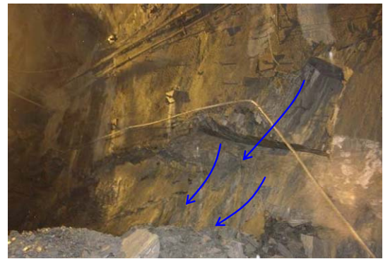
图 25 富水断层破碎带在开挖后局部滑塌
