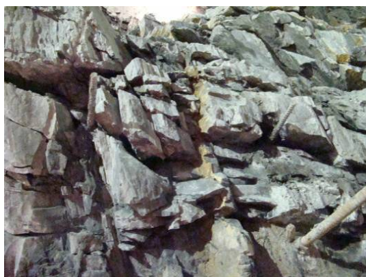
图 21 密集结构面已张开的高边墙
