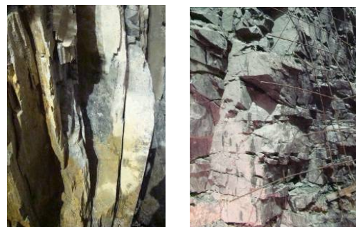
图 18 主厂房和主变室的高边墙层面与节理面张开
