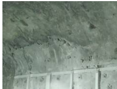
图 17 主厂房下游拱座喷混凝土外鼓并错位
