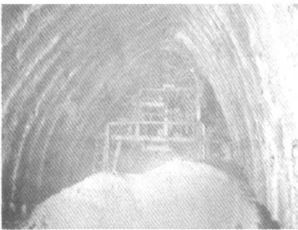
图15 隧道右线掌子面出现塌方
