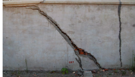
(b) 东主井井区围墙开裂情况
