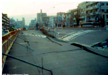
图 2 大开车站顶板坍塌导致的路面沉降
