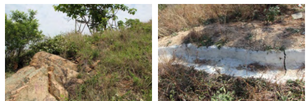
图 14 地表卸荷裂缝
