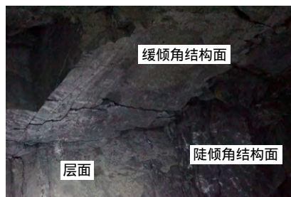
(a) 已掉落块体
