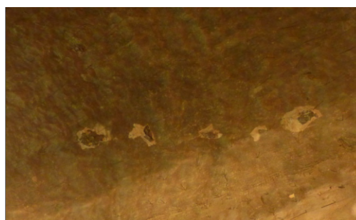
(a) 2 # 导流洞右侧拱肩喷层开裂（桩号 K0+470 ~ K0+490）
