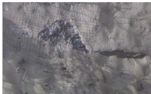
(c) 5 # 导流洞左侧拱肩喷层开裂（桩号 K1+210 ~ K1+230）
