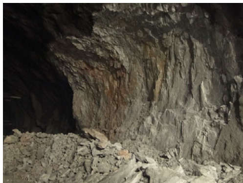
图7 “2·23”岩爆爆坑和揭露的结构面
