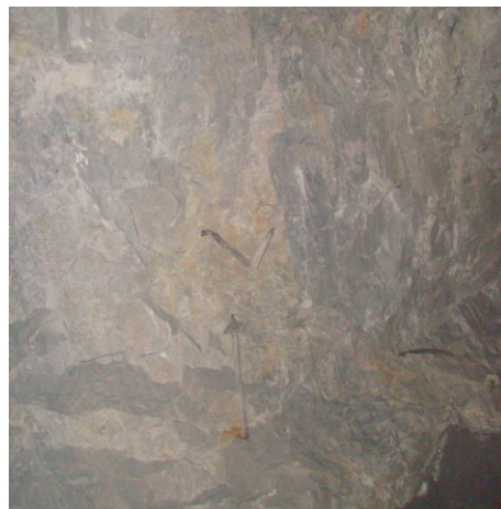
图 9 锦屏二级水电站张拉板裂型岩爆实例
