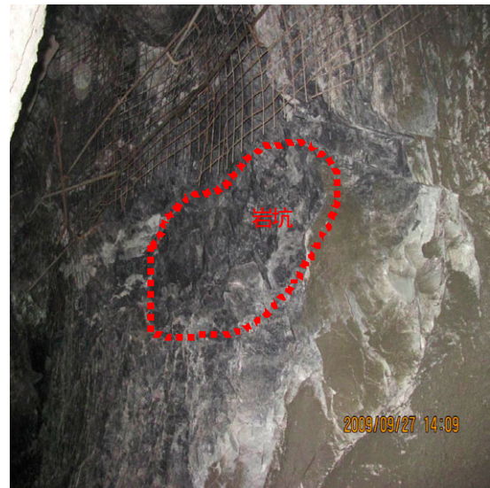
图 10 隧洞开挖现场破坏图片
