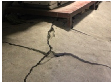
图 2 2.0 m 绞车基础后缘裂缝
