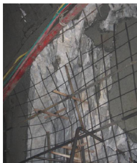
图 10 板裂化岩爆坑 [50]
