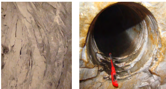
(a) 出露于洞壁 (b) 钻孔探视 图1 锦屏二级水电站隧洞围岩板裂化破坏现象
