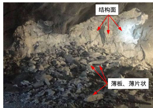
(a) 结构面与隧洞轴线呈小夹角
