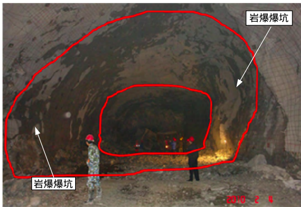
(a) 两侧边墙岩爆破坏
