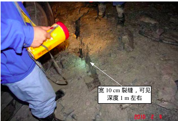
(b) 上台阶底板岩爆裂缝
