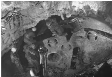
图2 挤压大变形导致TBM发生卡机灾害
