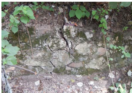
图 24 拦洪坝区域地表裂缝 Fig.24 Surface cracks of Lanhongba
