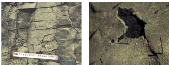
(a) 边墙缓倾角隐节理张开 (b) 侧拱喷射混凝土剥落
