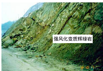
图 3 滑坡开挖坡面前缘剪出口
