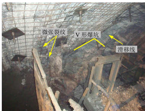
图 4 2010 年 6 月 11 日即时性应变-结构面滑移型岩爆造成岩体宏观破坏情况
