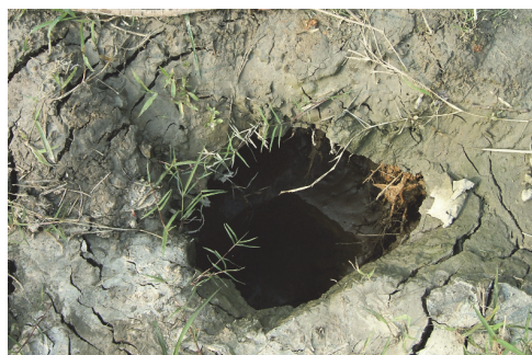
图2 气体与水将泥沙带走而造成地面塌陷
