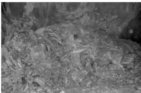
图 3 引(3) 1+670~1+690 段北侧边拱出现坍塌
