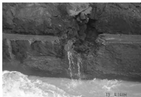
(b) 溢洪道东侧渗水位置
