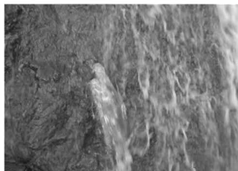
(a) 二期与三期坝坝体背水面渗流位置
